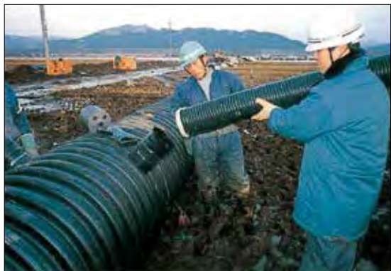
農地排水 (地下排水)
