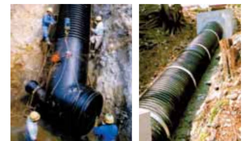
水力発電施設からの放流管
